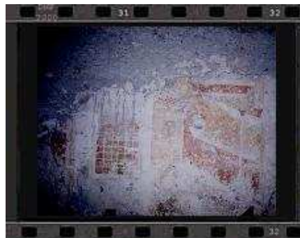
Pictura degradata din interiorul bisericii
